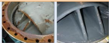
Zkorodovaný klapkový ventil – před a po opravě
