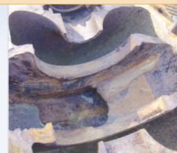
Obr. 1: Koroze a eroze povrchu byly zjevné
