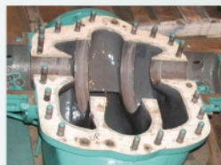
Rekonstrukce zcela zničeného povrchu (eroze)
